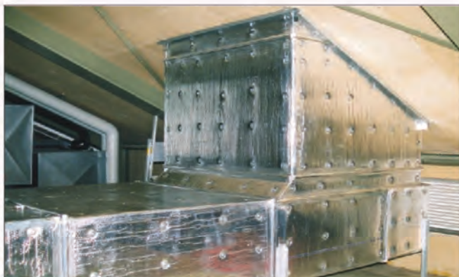
Astro-Foil isolasjon på utluftkanal
