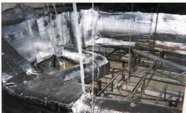
Astro-Foil isolasjon på tilluftskanaler
